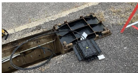
Chambre de tirage et de raccordement
